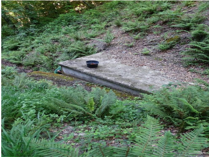
Illustration 5 : le toit de l'abri maçonné, vu depuis les hauteurs de la ravine
